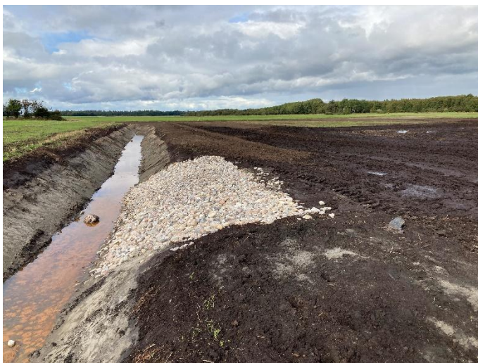
Figur 8: Eksempel på etableret overløbskarm til håndtering af overfladisk afstrømning.
