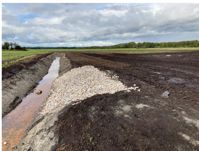
Figur 4-5: Eksempel på etableret overløbskarm til håndtering af overfladisk afstrømning.
